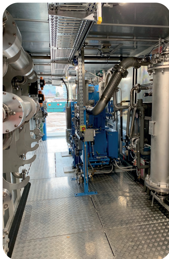
Installation de traitement du biogaz en conteneur
