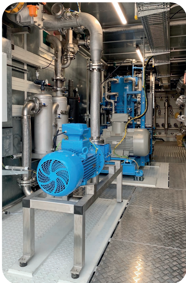
Biogasaufbereitungsanlage im Container
